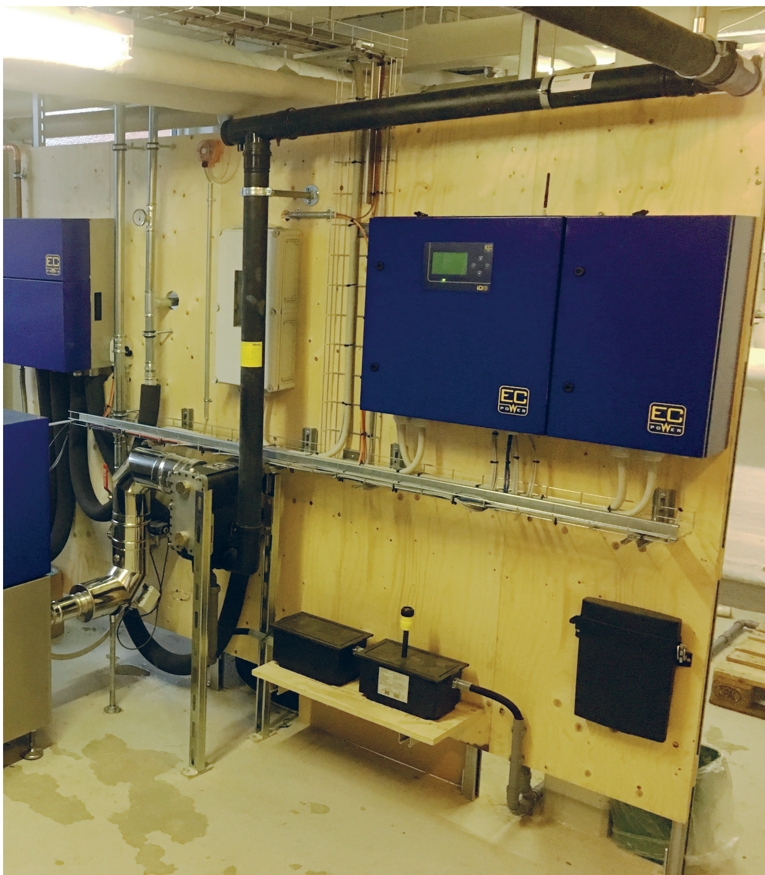
XRGI-anlæg på Andst Børne- og Skolecenter i Vejen Kommune, der har i alt fem XRGI-anlæg – tre på skoler, et på et plejecenter og et anlæg på et områdekontor.
