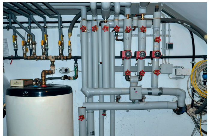
Der bereits vorhandene Warmwasserspeicher könnte einige Nummern größer sein, um die Wirtschaftlichkeit des Betriebs noch zu erhöhen. Bei einer Laufzeit der KWK-Anlage von bereits 7600 h/p.a. ist die aber höchstens noch um ein oder zwei Prozentpunkte zu toppen.
