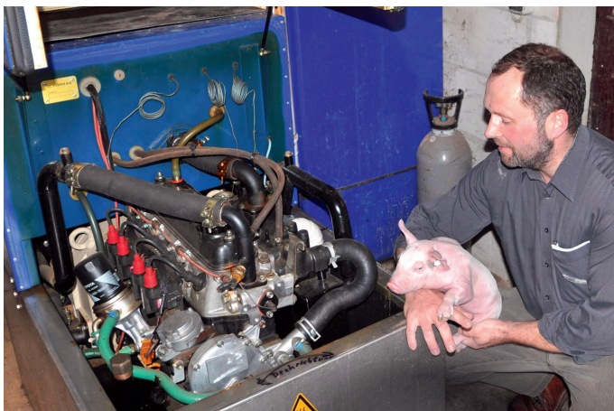
Das Klein-BHKW liefert die Grundlast an Wärme und Strom für die Ferkelaufzucht und für das Wohnhaus. Im Bild ist die Schallschutzhaube aufgeklappt.
