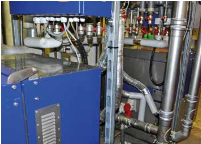
Normalerweise gehört zu den XRGi-Einheiten ein Wärmeverteilungsmodul. Ein solches zu installieren gestatteten die Verhältnisse im Caritas-Haus nicht. Die Anlagenbauer mussten sozusagen in Handarbeit die beiden Einheiten an den Wärmeverteiler anschließen.
