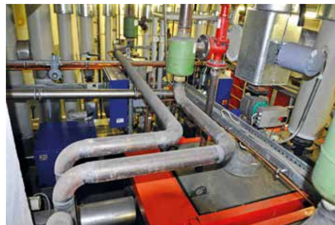
Die Umrüstung machte Schwierigkeiten. Die beiden Blöcke 1 (rechts) und 2 (links) ließen sich nur schwer unterbringen. Ursprünglich war geplant, alle drei Ölkessel gegen KWK auszuwechseln. Das ließen die Räumlichkeiten aber nicht zu.
