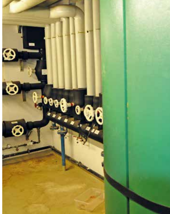
Die Trinkwasserspeicher werden nicht von einem Energiemanagement angesteuert. Sie entnehmen sich die notwendige Wärme aus dem zentralen Verteiler. Da sie ohnehin den beiden XRGi beinahe die gesamte Leistung abnehmen, durfte eine aufwendigere Regelung entfallen.
