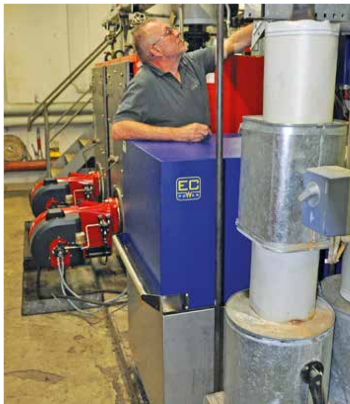
Block 1 der Zweier-XRGI-Kaskade mit je 15 kW elektrisch und 30 kW thermisch. Die beiden verbliebenen Ölkessel à 500 kW müssen in der Sommerzeit maximal in den frühen Morgenstunden oder abends den XRGI-Maschinen zur Warmwasserbereitung zur Seite stehen.
