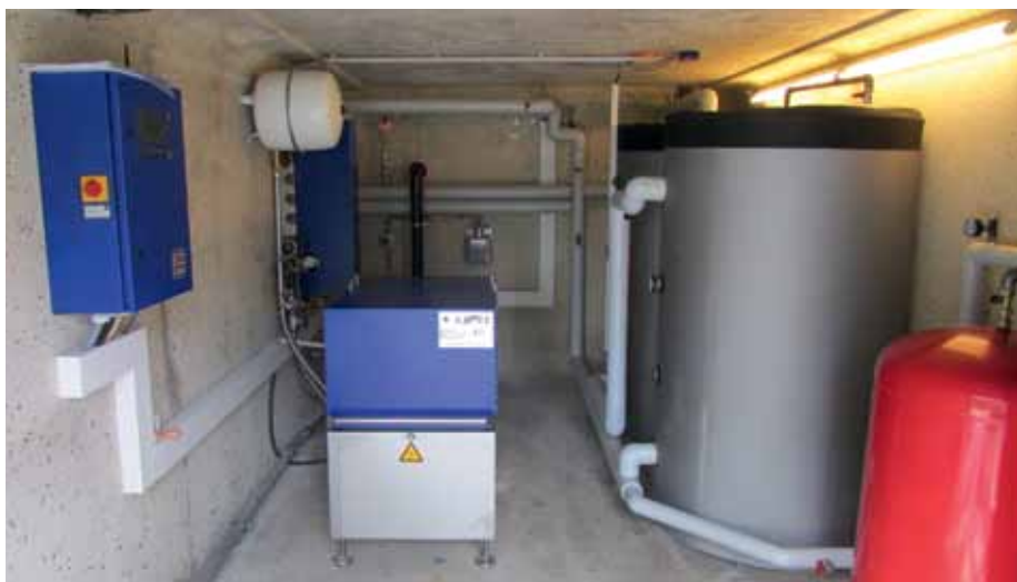
Das XRGI 6 von EC Power (Mitte) arbeitet mit 93 % Gesamtwirkungsgrad äußerst effizient.
