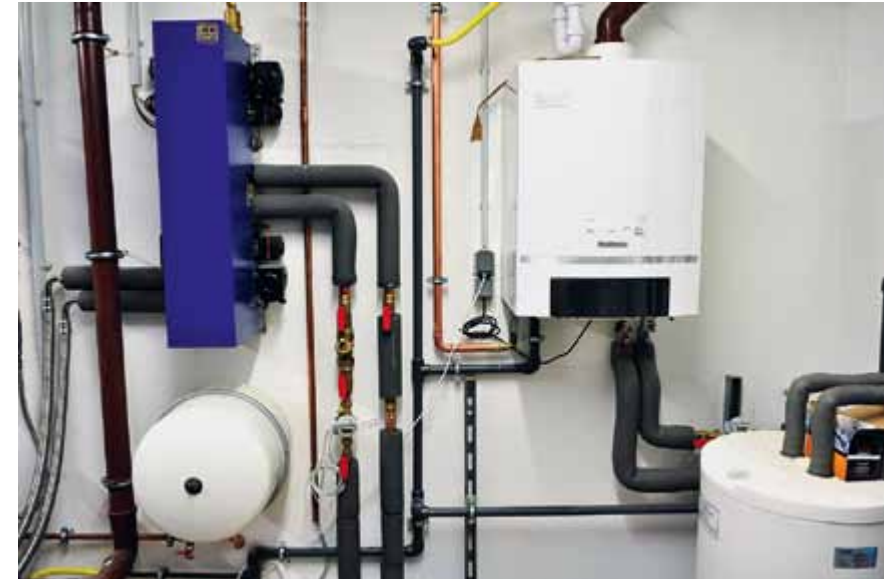
Die Gasbrennwert-Spitzenlasttherme muss im Parallelbetrieb maximal 20% der Jahresheizarbeit leisten
