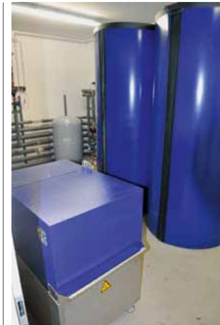
XRGI 6 und Pufferspeicher in der Anlage Runnebaum
