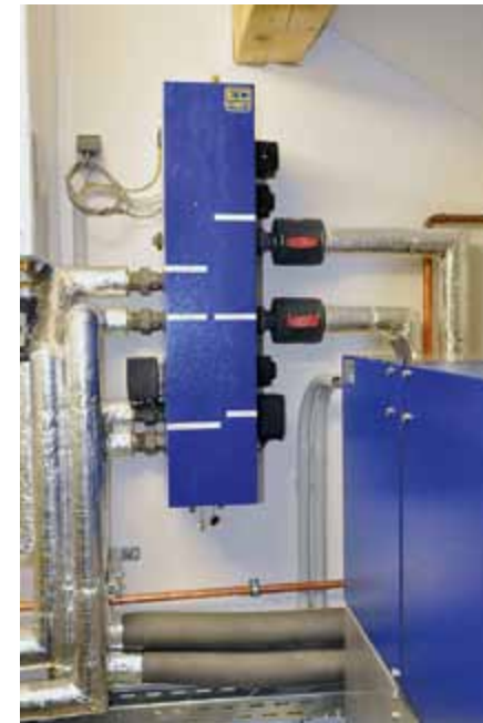
Dachzentrale mit BHKW-Modul und Wärmeverteilungs-Modul. Schallschutz durch eine Verbindung mit flexiblen Leitungen
