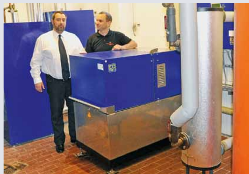
Mehrheitlich akzeptieren die Mieter die neue Kellerzentrale nebst dem Strombelieferungsvertrag
