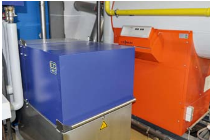
Für KWK, hier mit Spitzenlastkessel, stellt das UEP eine Sonderförderung bereit
