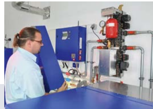
Die Maschine ist eine Blackbox, die Peripherie mit Wärmetauschern, Armaturen, Pumpen klassische Heizungstechnik. Die moderne „Plug-and-play“-Technik sollte sowohl für das Planungsbüro als auch für den Meisterbetrieb kein Problem sein (Bilder: BHK-Systeme)
