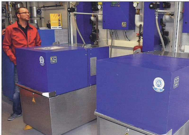
Die zwei BHKW-Module XRGi-20 mit jeweils 20/40 kW elektrisch/thermisch liefern Heizungswasser von etwa 80 °C. Ein Mischer am Eingang Nahwärme reduziert diese Hochtemperatur auf eine Vorlauftemperatur zu den Plattenheizkörpern von 65 °C. Im Bild: Anlagenbauer Bernd Mirschberger ( www.mirschberger.de )
