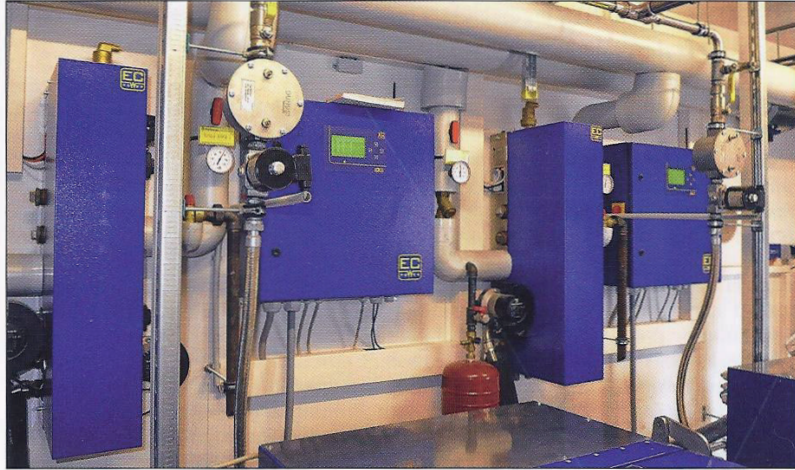
Erlangen, Liguster Weg. Zu jedem der beiden XRGi-20-Maschinen gehört ein Wärmeverteil-Modul (jeweils links), das das Heizungswasser in den Pufferspeicher oder direkt ins Nahwärmenetz lenkt, sowie das Energiemanagement-Modul. Werksseitig sind die drei Teile bereits als eine Einheit konfiguriert. Alle Funktionen sind integriert – ohne komplizierte und zeitaufwendige Extraanschlüsse.
