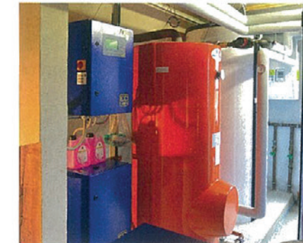
Drei Pufferspeicher kommen zum Einsatz: Der blaue Speicher ist mit dem BHKW verbunden, der weiße Puffer dient zur Trinkwassererwärmung, der orange Behälter speichert die Abwärme der Kältemaschinen.
