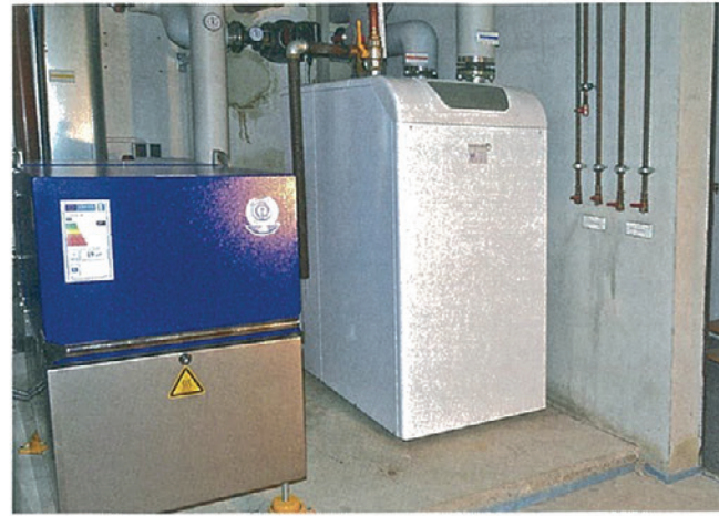
Gewährleisten die Wärmeversorgung: das Erdgas-BHKW vom Typ XRG1 9 des Herstellers EC Power und der Brötje-Gas-Brennwertkessel EuroCondens SGB 170 H.
