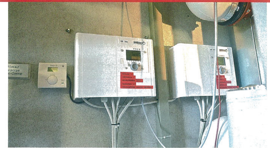
Die zwei Systemregler ISR ZR2 sorgen für den optimalen Betrieb der Wärmeerzeuger.
