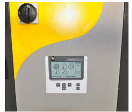
Die Wärmepumpensteuerung „Navigator“ mit ausgereifter Kommunikationstechnik ist sehr anpassungsfähig. Sie erlaubt, die KWK-Anlage über das Internet, über Mobiltelefon, über ein BUS-System oder direkt anzufahren. Für den Verbund BHKW/Wärmepumpe stimmte IDM die Elektronik auf die von EC-Power vorgegebene Regelungsstrategie ab. www.idm-energie.at
