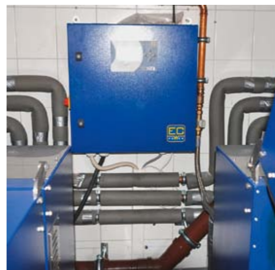
Im Steuerschrank werden entsprechend dem Wunsch des Kunden die drei möglichen Betriebsstrategien für das BHKW programmiert: wärmegeführt, stromoptimiert oder aber tarifgeführt
