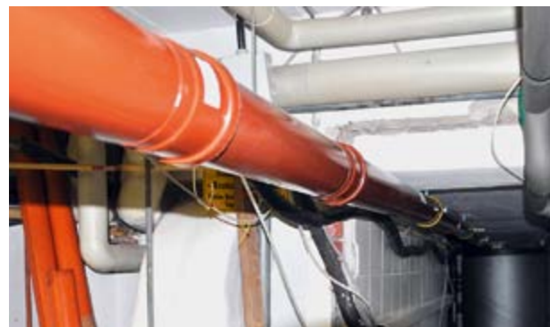
Die Zuluftleitung von der Wärmepumpe zum BHKW-Betriebsraum. Im Hintergrund sind die Wärmespeicher zu erkennen
