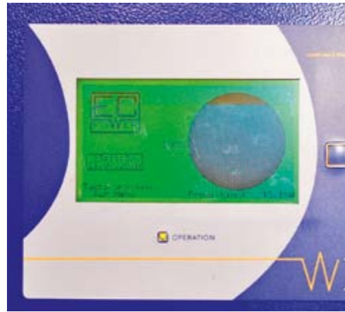
21. Juli 2010. Trotz Hochsommers fährt das BHKW im „Stranddeck“ mit voller Leistung, weil der Warmwasserbedarf (Schwimmbad) hoch ist
